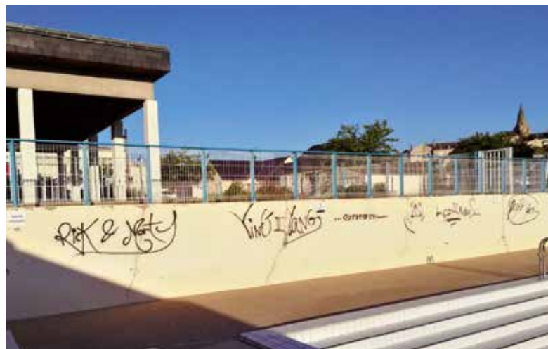
Ce type de dégradations est passible de sévères amendes.
