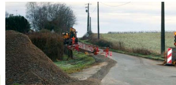
Avant l'aménagement de la chaussée, des travaux sur le réseau d'eau potable ont eu lieu en janvier.
