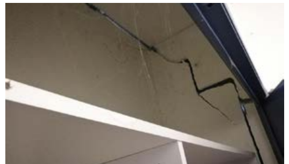
Les fissures sont très importantes et ont nécessité la fermeture provisoire de la salle de basket.
